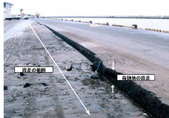
参考写真② 荷捌き地の段差
