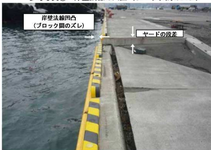
参考写真③ 岸壁法線の凹凸、ヤードの段差
