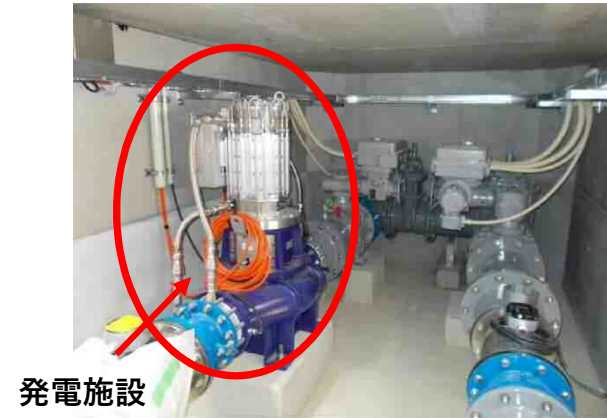
豊田市高岡配水場での設置事例
