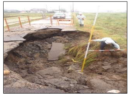
矢作川沿岸 (南部幹線水路の漏水)
