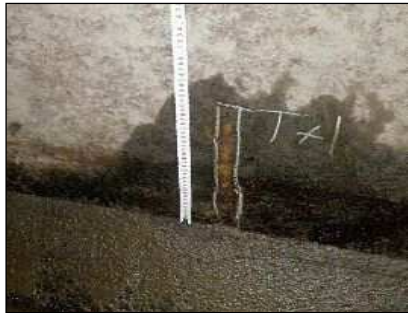
宮田用水施設 (鉄筋の露出)
