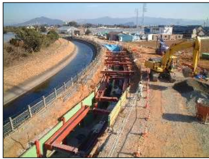
豊川用水二期 (西部幹線併設水路)
