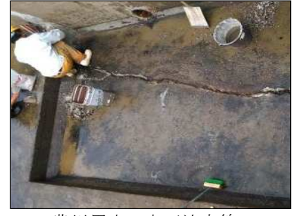
豊川用水<大正池支線> (吐水槽のクラック)
