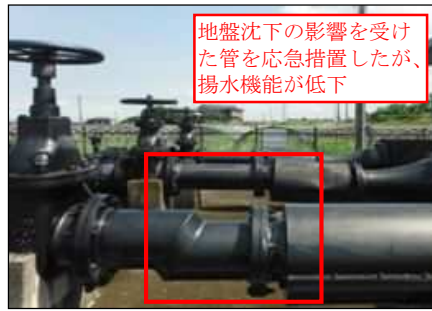
木曾川用水濃尾第二施設改築 (揚水機場の地盤沈下状況)
