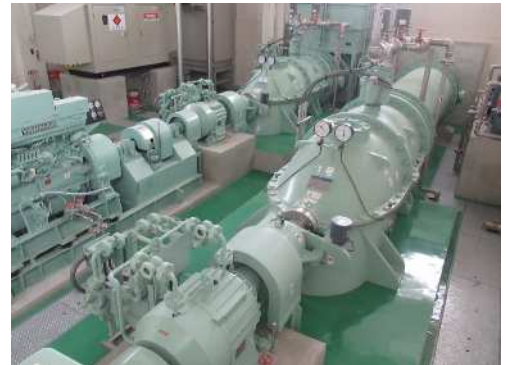
【植田排水機場】
