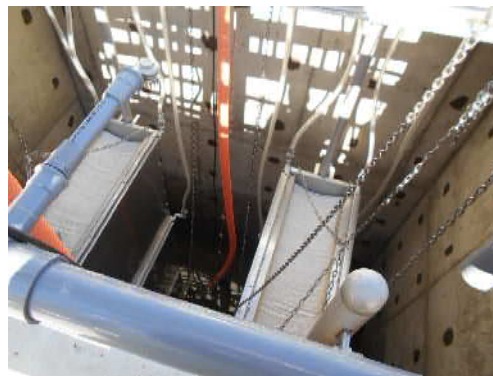
【汚水高度処理施設】
