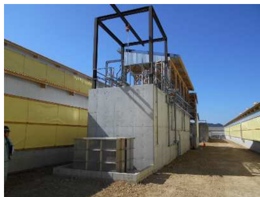
【汚水処理施設】
