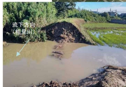
写真① 破堤箇所(近景) 9/24 7:30
