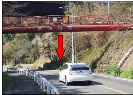
愛知用水<師崎支線> (地震時に落下が危惧される水管橋)
