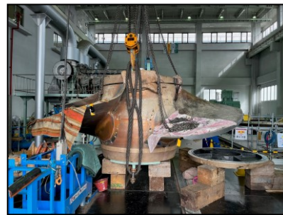
尾張西部 (日光川河口排水機場)
