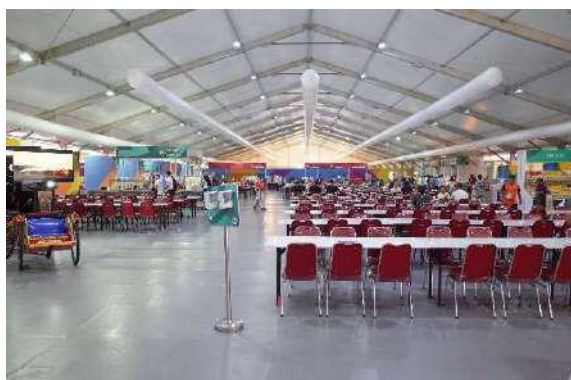
大型テントに布製のダクトを利用した例
