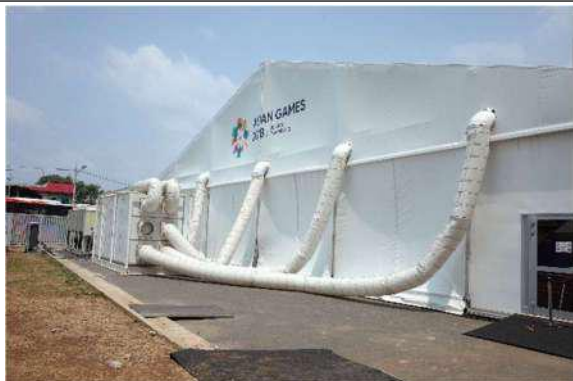
空調機を屋外に設置した例
