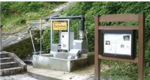
農業用水を利用した小水力発電施設（新城市四谷地区）
