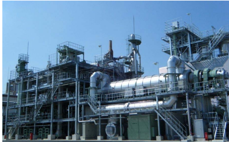
図 3-20 下水汚泥燃料化施設（衣浦東部浄化センター）
