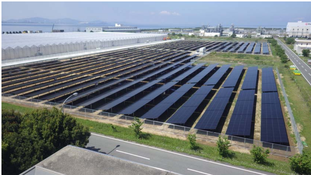
図 5-6 太陽光発電施設の設置状況 (豊川浄化センター)
