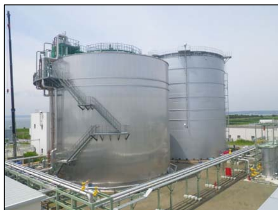
図 5-8 メタン発酵施設、ガスタンク (矢作川浄化センター)
