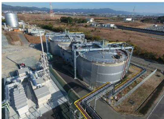
豊川浄化センターの消化槽・発電機
