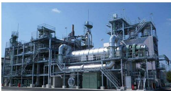
衣浦東部浄化センターの汚泥燃料化施設
