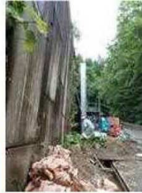
写真 壁面の傾斜の例
