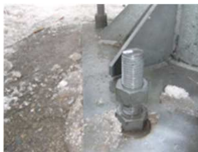
写真-解 6-1 新設後 1 年程度の附属物のアンカーボルトのゆるみ
