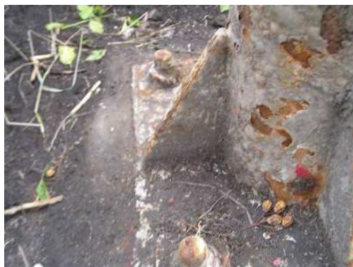
路面境界部が土砂で覆われている場合
