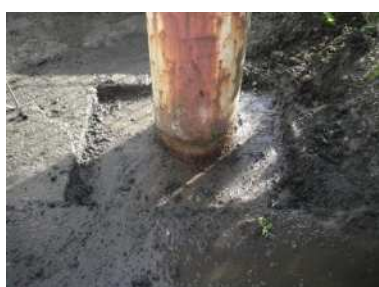
GL-0 に腐食が見られる場合 (塗装式、アスファルト)
