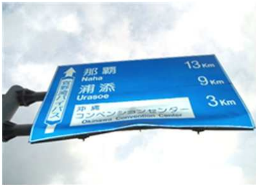
道路標識板の変状状態
