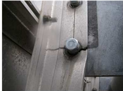
取付部の変状状態
