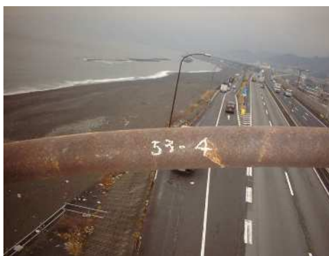
写真-解 8-11 支柱本体の腐食事例
