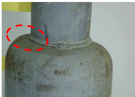
照明柱断面変化部の溶接に確認された亀裂 (歩道橋、15年経過)
