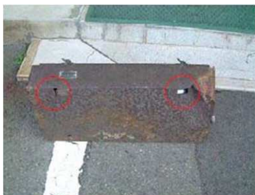
落下照明背面状況
