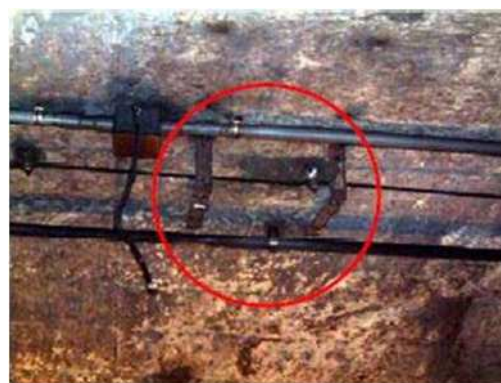
落下照明取付部の状況
