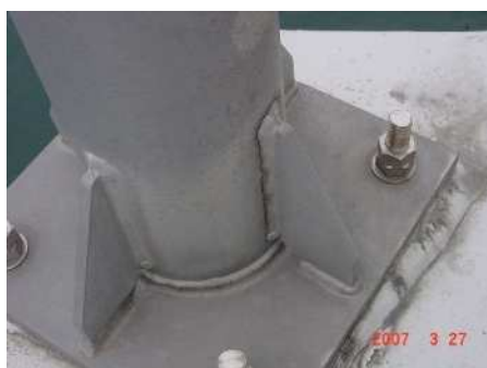
標識柱基部溶接部の亀裂
