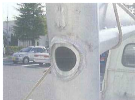
アルミ製デザイン照明柱横梁アーム落下 (強風により発生)
