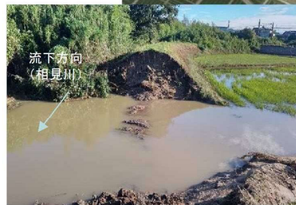
写真① 破堤箇所 (近景) 9/24 7:30
