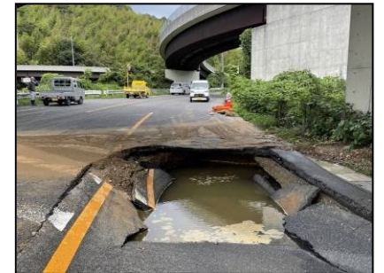
矢作川沿岸 (南部幹線水路の漏水)
