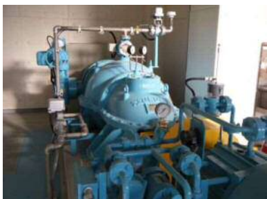
(鍋蓋新田排水機場ポンプ)
