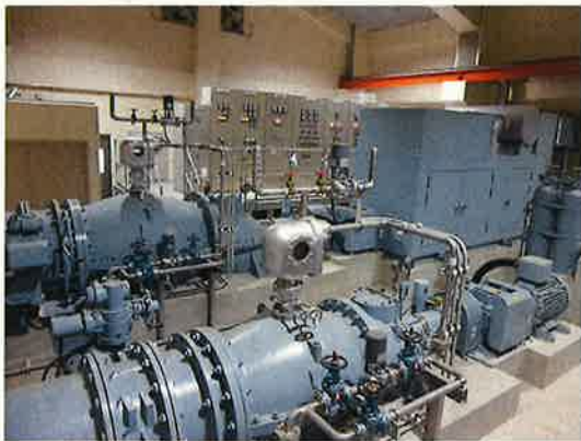
古瀬排水機場（愛西市）
