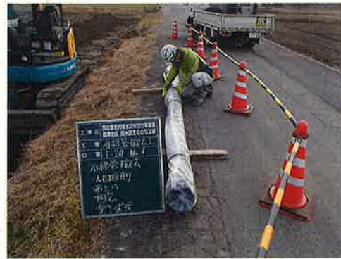
石綿セメント管の撤去(弥富市) 〔特定農業用管水路特別対策事業〕
