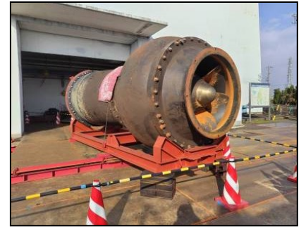
尾張西部 (尾西排水機場)
