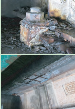
橋梁の老朽化
