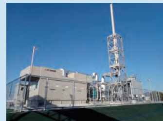
バイオガス発電 (電力会社へ売電:豊川浄化センター)
