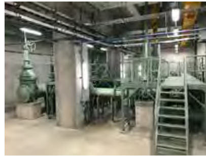
処理場ポンプ設備設置状況 (日光川上流浄化センター)
