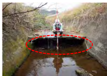
溪流保全工の劣化状況
