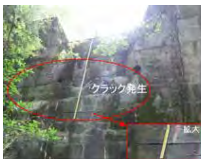
砂防堰堤の劣化状況
