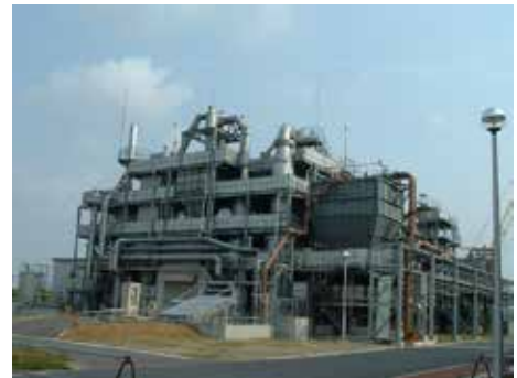
汚泥減量化施設（焼却炉）
