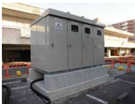
非常用電源 72 時間化
