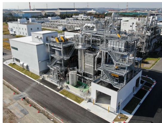
▲共同汚泥処理施設の運用 衣浦西部浄化センター(半田市)
