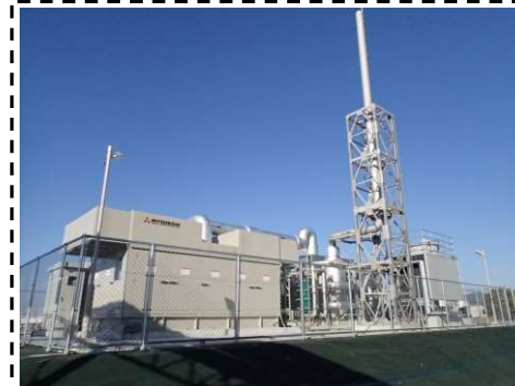
豊川浄化センター (豊橋市) 発電施設
