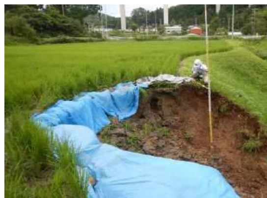
大雨による田ののり面崩壊（岡崎市）
