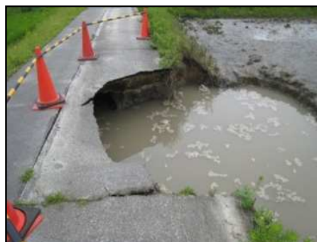
支線水路（漏水による道路の陥没）
