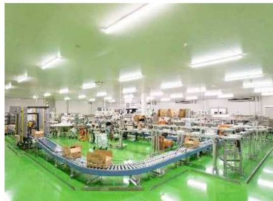
畜産クラスター事業により整備された衛生的なGPセンター※
