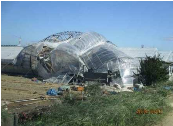
大型台風による園芸施設の倒壊
