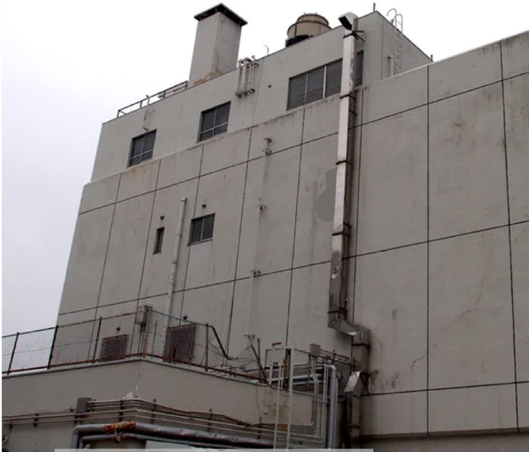
④煙突用石綿断熱材
