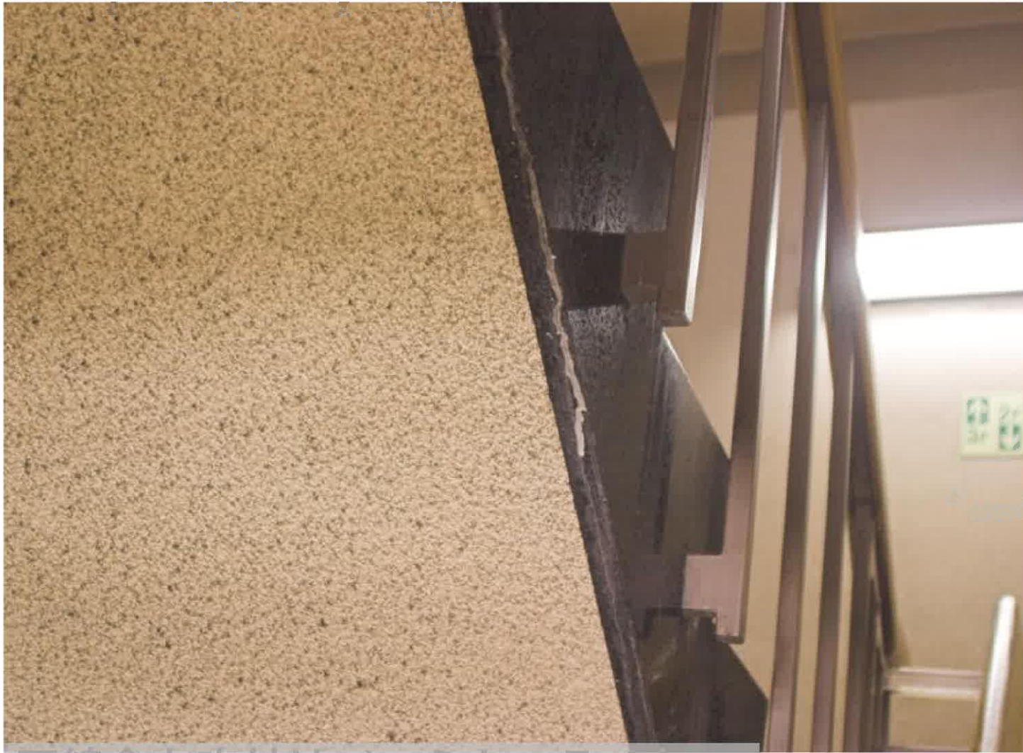
石綿含有吹付けバーミキュライト
